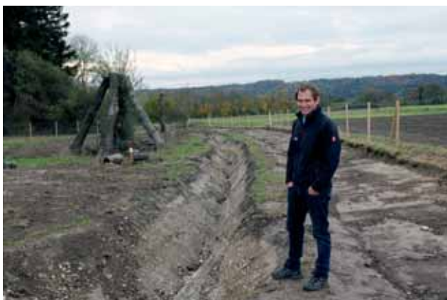
Foto: Projektleiter Martin Stahl auf der Baustelle mit Bachlauf, Greifvogel-Habitat, Saatbett für Magerwiese und Wildschutzzaun
